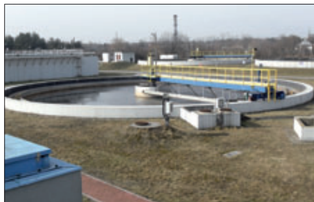
Oczyszczalnia ścieków komunalnych w Starachowicach
